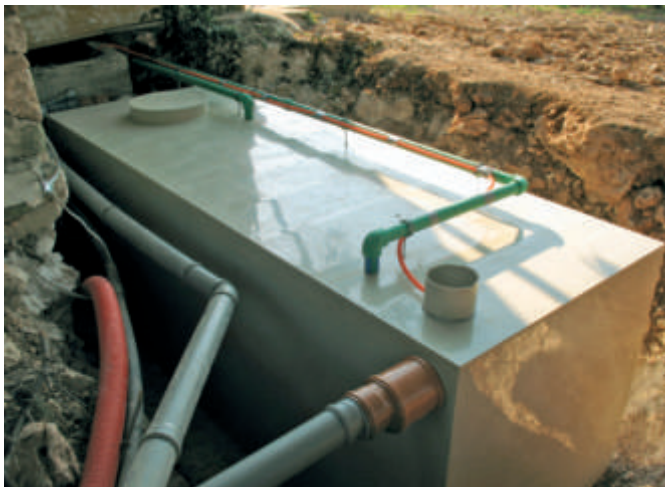
Ilustracija 7 Separator otpadnih voda i dio cijevnog sustava
