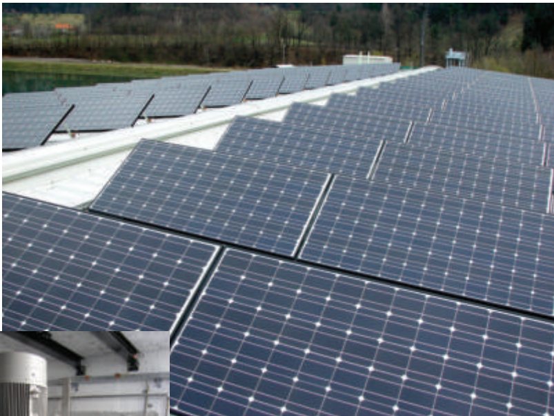
Ilustracija 11 FN moduli postavljeni na krovu strojarnice elektrane
