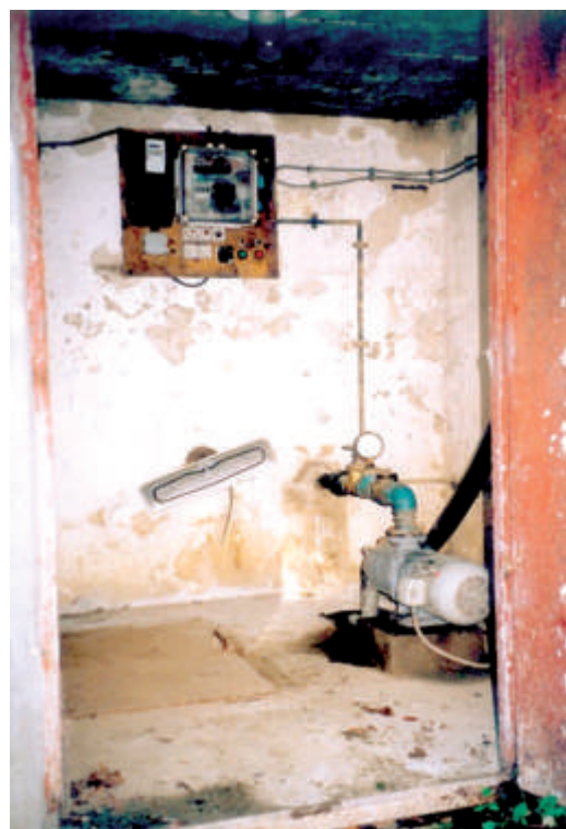
Ilustracija 8 Objekt kaptaze s crpnom stanicom lokalnog vodovoda u Varaždinskoj županiji
