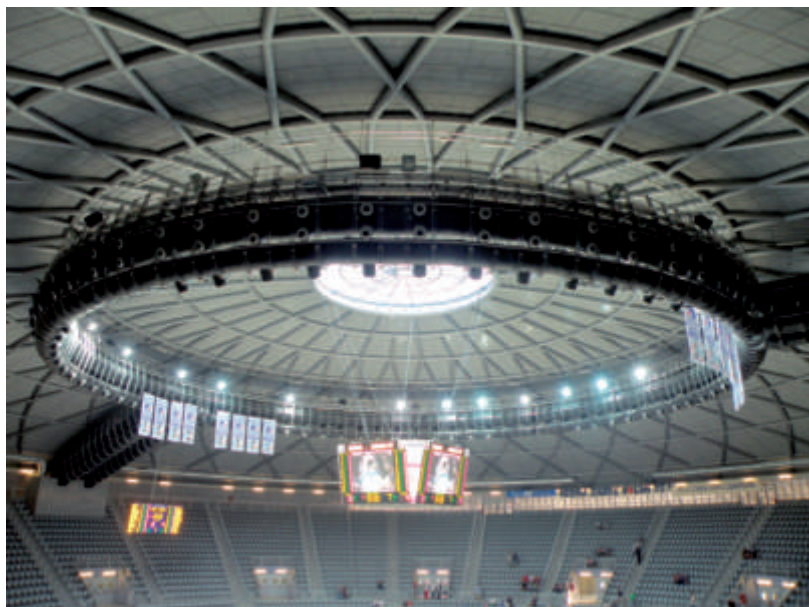
Zanimljivo rješenje ventilacijskih kanala za razvod zraka u dvoranu (i najveći dvoranski semafor u Hrvatskoj!)
