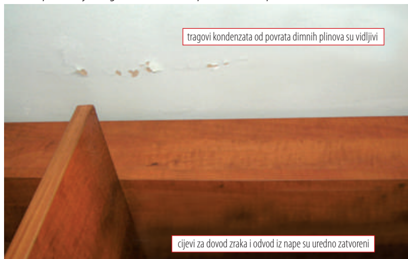
Ilustracija 9 ... na stropu su vidljivi tragovi kondenzata od povrata dimnih plinova
