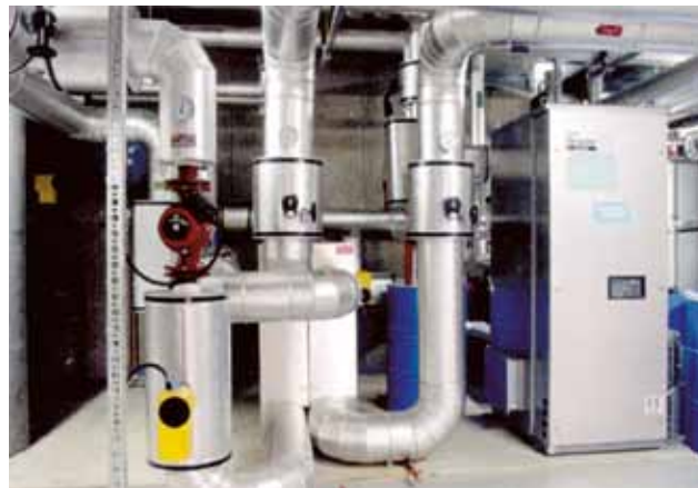
Ilustracija 4 ... i apsorpcijski rashladni uređaj u strojarnici zgrade
