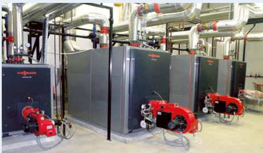
... i kotlovnica koja je spremna za korištenje prirodnog plina
