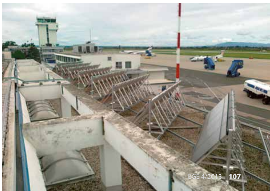
Ilustracija 1 Polje solarnih kolektora na krovu objekta Cateringa
