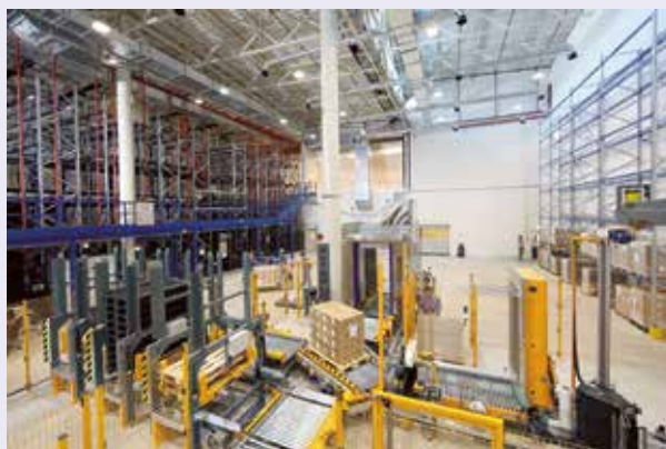
◀ Tu je i posve automatizirano visokoregalno skladište
