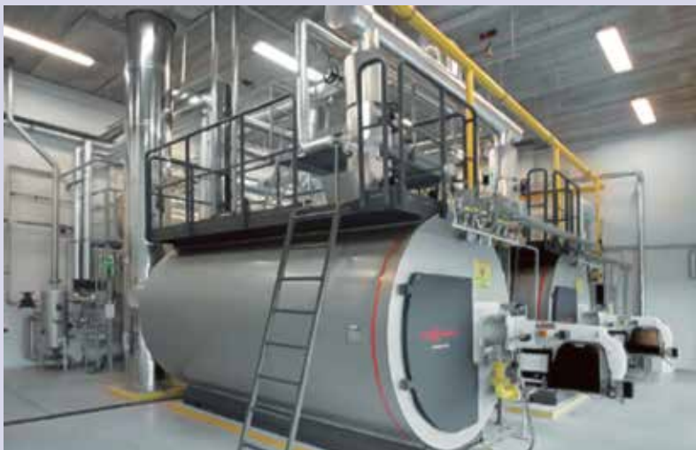
▼ Nalcova tehnologija osigurava energetske učinkovitost i uštede
