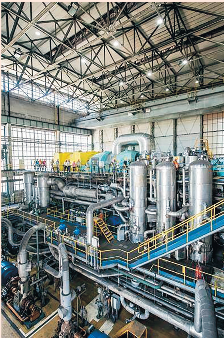
▲ Strojarnica TE Plomin 2
